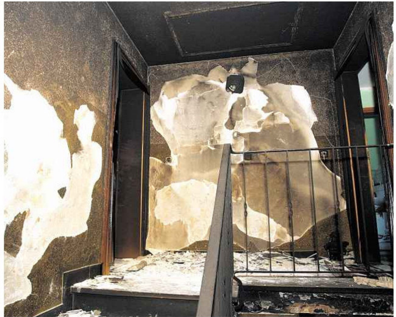
Der Gelbe Sack war offenbar gut gefüllt, denn beim Brand im Treppenhaus müssen Temperaturen von mehreren hundert Grad entstanden sein. Sogar Schalter und Steckdosen waren geschmolzen. Foto: Ralf Roeger
