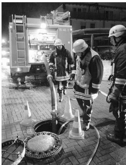
Pumpen, was die Pumpen hergeben: Die Feuerwehr – hier der Löschzug Verlautenheide – arbeitet mit voller Kraft gegen die Wassermassen.
