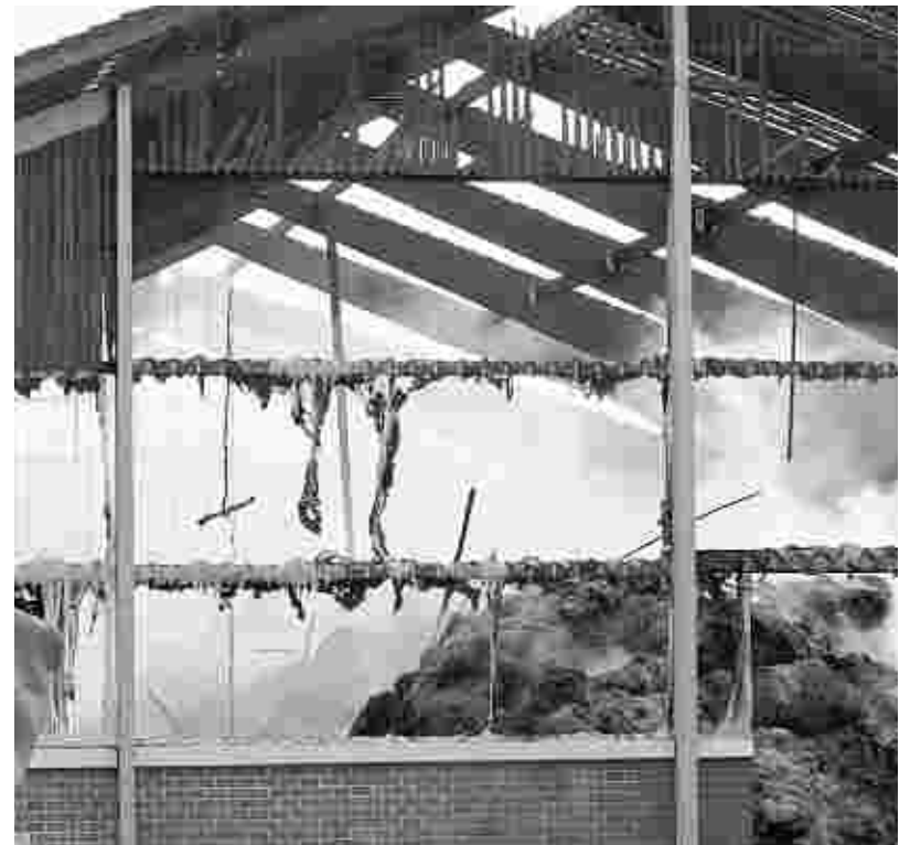
Die Trümmer qualmen noch: Da die Halle wegen Einsturzgefahr nicht betreten werden kann, lässt die Feuerwehr das Stroh kontrolliert abbrennen. Foto: Wolfgang Piltzner
